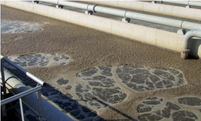
Foto 3. Reactor biológico línea 1 sin dosificación de ozono
