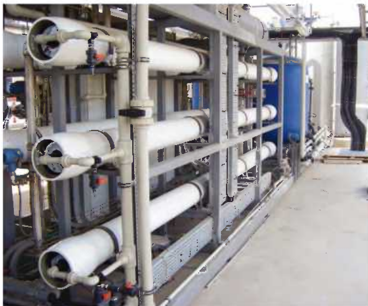
Figura 2. Vista parcial del sistema de ósmosis inversa.
