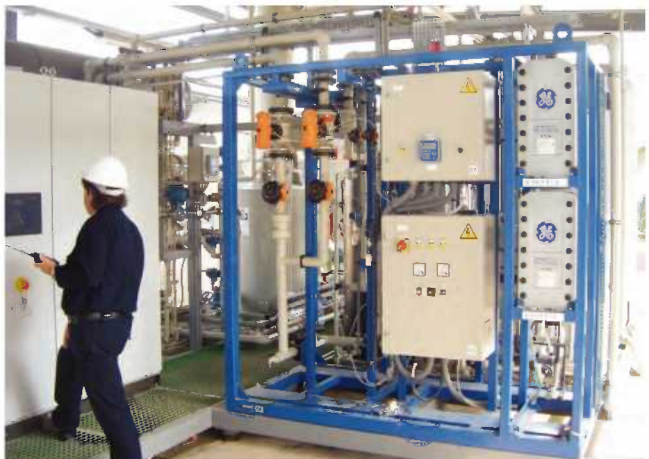
Figura 3. Vista parcial de la unidad de electrodesionización.
