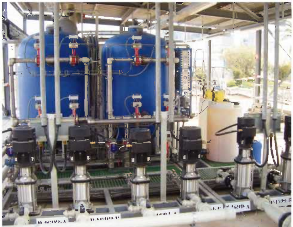
Figura 1. Vista parcial del pretratamiento.
